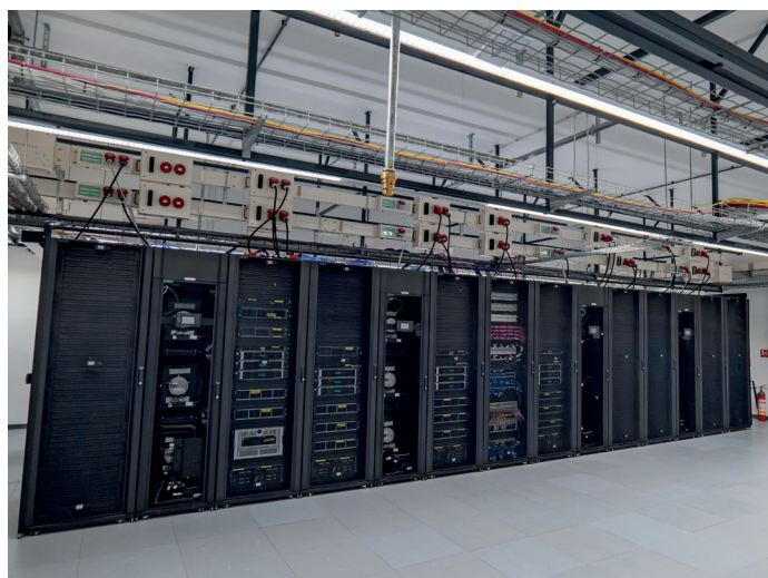
Računalni ormari u podatkovnom centru HR-ZOO ZG2 na Znanstveno-učilišnom kampusu Borongaj Sveučilišta u Zagrebu
