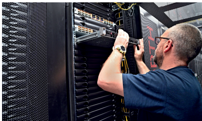
Oprema CIX-a u računalnim ormarima u podatkovnom centru DC North
